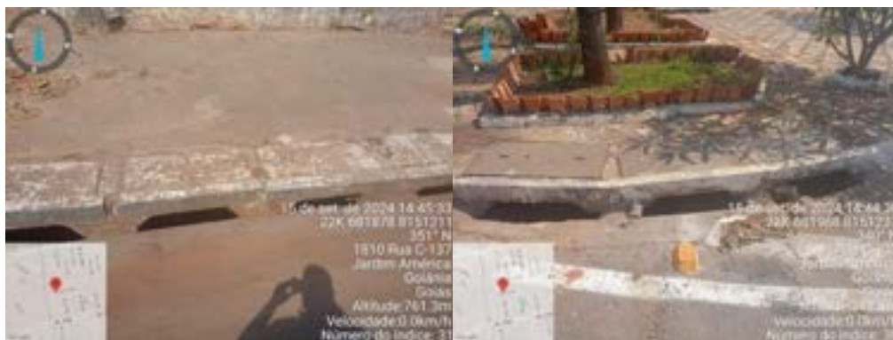
Figura 18 e Figura 19. Presença de resíduos e obstruções de entrada da água nos pontos 9 e 10
