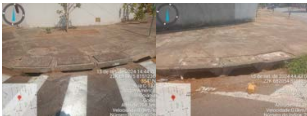
Figura 20 e Figura 21. Pontos 11 e 12 com repetição do problema de obstrução de entrada, porém com posicionamento adequado
