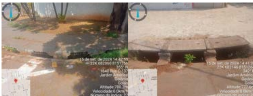
Figura 22 e Figura 23. Presença de resíduos e vegetação saindo das bocas de lobo, o que indica obstrução dos canais por excesso de sedimentos nos pontos 13 e 14
