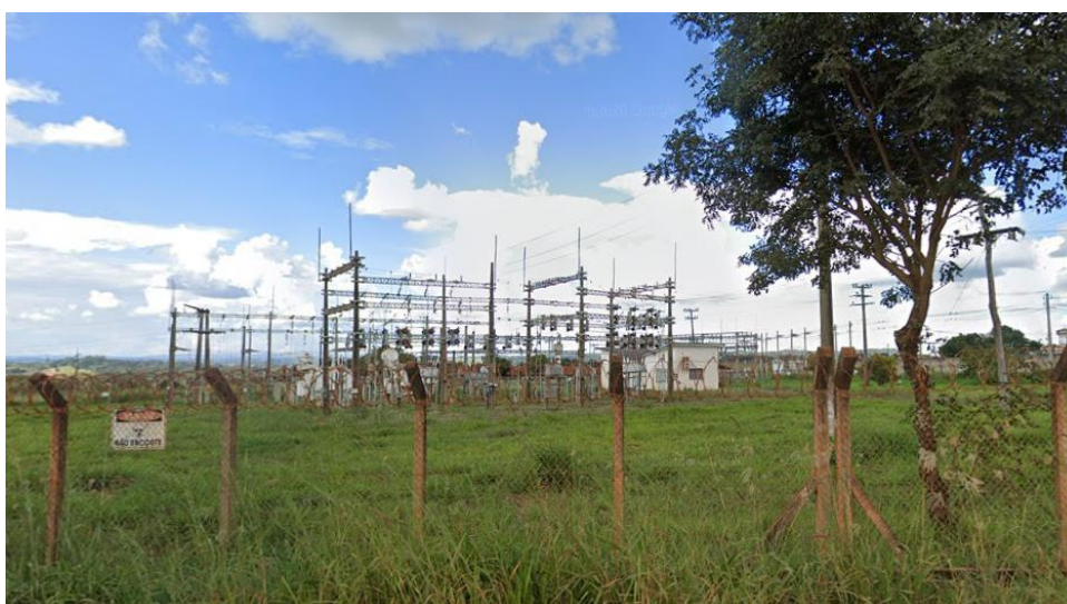
Figura 06: Estação de abastecimento elétrico.
