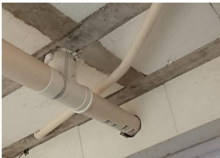
Figura 4 – Laje danificada na cozinha para passar tubulação hidráulica.
