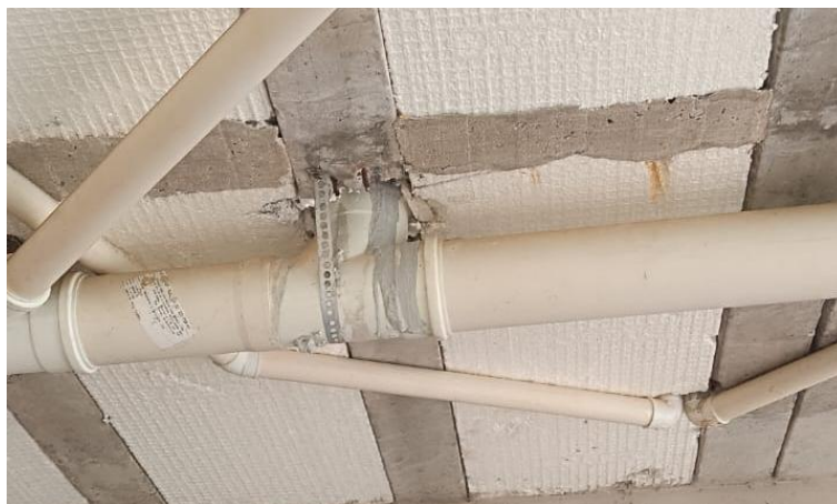
Figura 3 – Laje danificada na varanda para passar tubulação hidráulica.
